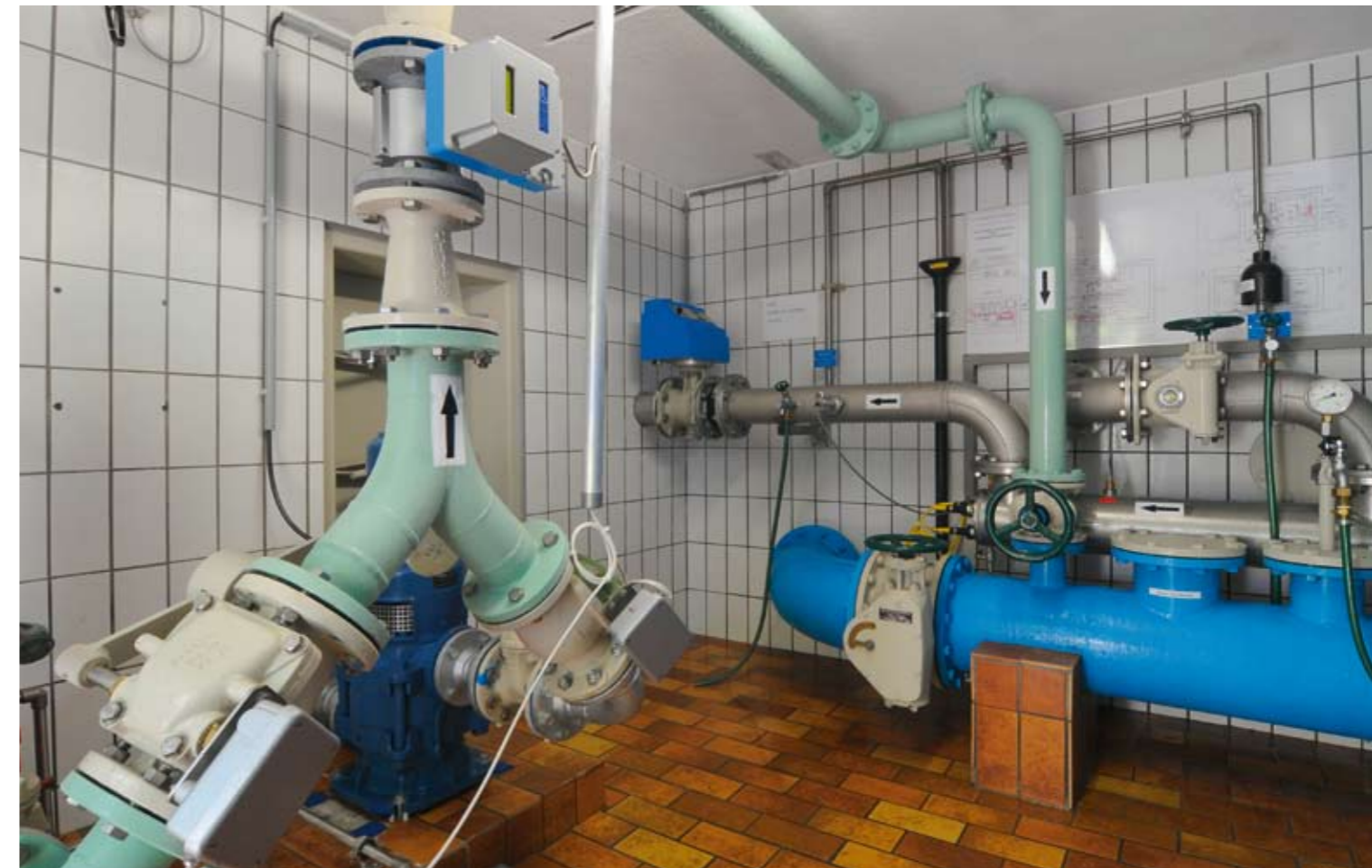
Pumpwerk Walserbach, Schaanwald
