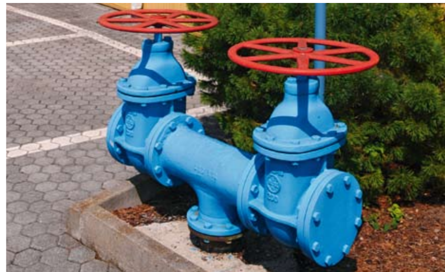
Alte Schieber aus dem Pumpwerk Oberau
