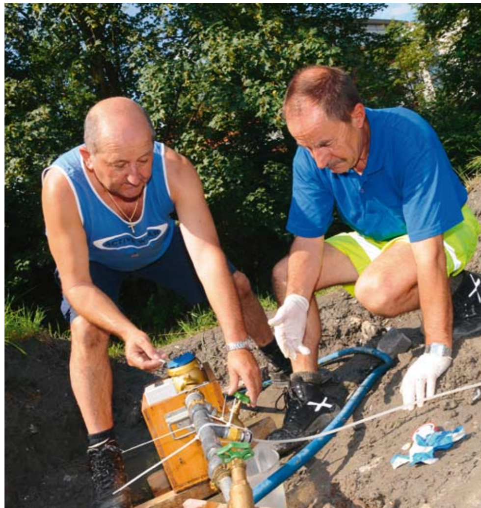
Norbert Marxer kurz vor der Pensionierung mit seinem Arbeitskollegen Anton Pfeiffer bei der Desinfektion einer Leitung
