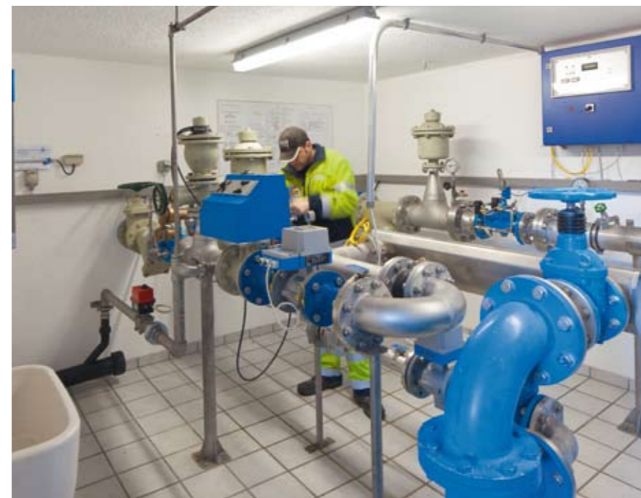
Messschacht Nendelerfeld in Nendeln
