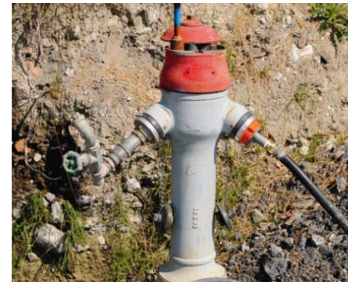
Provisorischer Wasserbezug ab Hydranten
